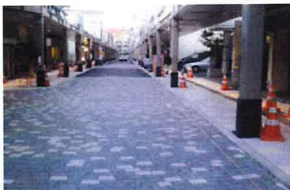
新潟一番堀通線改良工事の内 インターロッキング設置工事 (下請)
